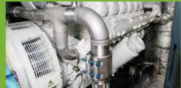
Das Herz der neuen Anlage: Das Blockheizkraftwerk.
